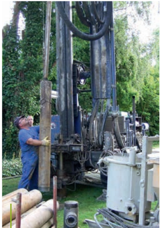
Auf dem Campus Minden wurden im September 2015 in 90 Meter Tiefe zwei Erdsonden für Geothermie in den Boden gebracht.
